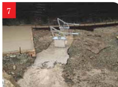
7 12"ダブルスライスキットを使用してスラリータンクを空にする
