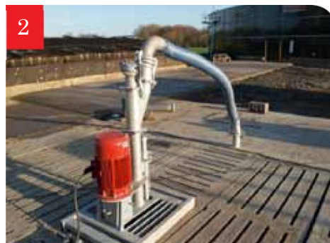
2 電動ポンプを使用してレセプションピット(一時貯蔵槽)を空にし、スラリータンクに移送する
